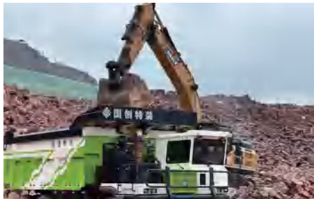
武穴工业园矿山配置的电动卡车
