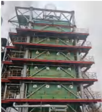
大冶公司高效 SCR 脱硝系统
